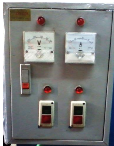
Hình 33. Tủ điện điều khiển máy
