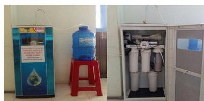
Hình 1. Hệ thống lọc nước deion hoàn thiện
